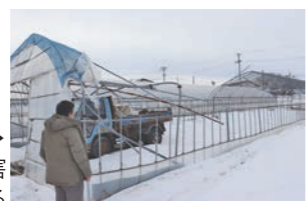
ハウス被害を確認する工藤常務
